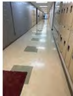
Non ACM 12x12 Floor Tile
