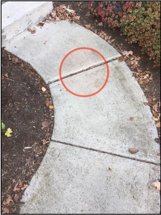
9. Uneven (trip hazard)
